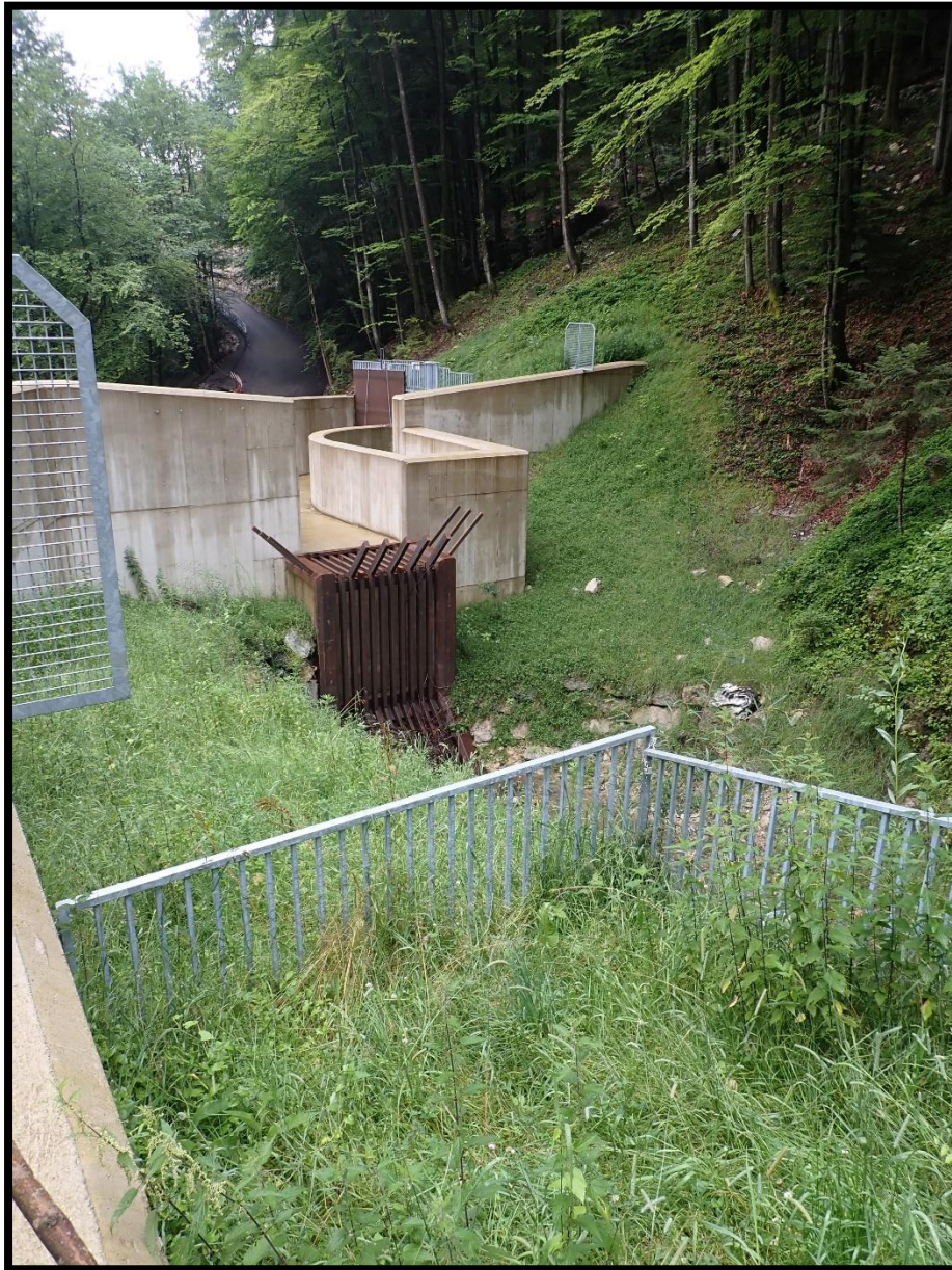
Abbildung 5: Streichwehr für Stollenausleitung (Foto: Reinhard Ribitsch)
