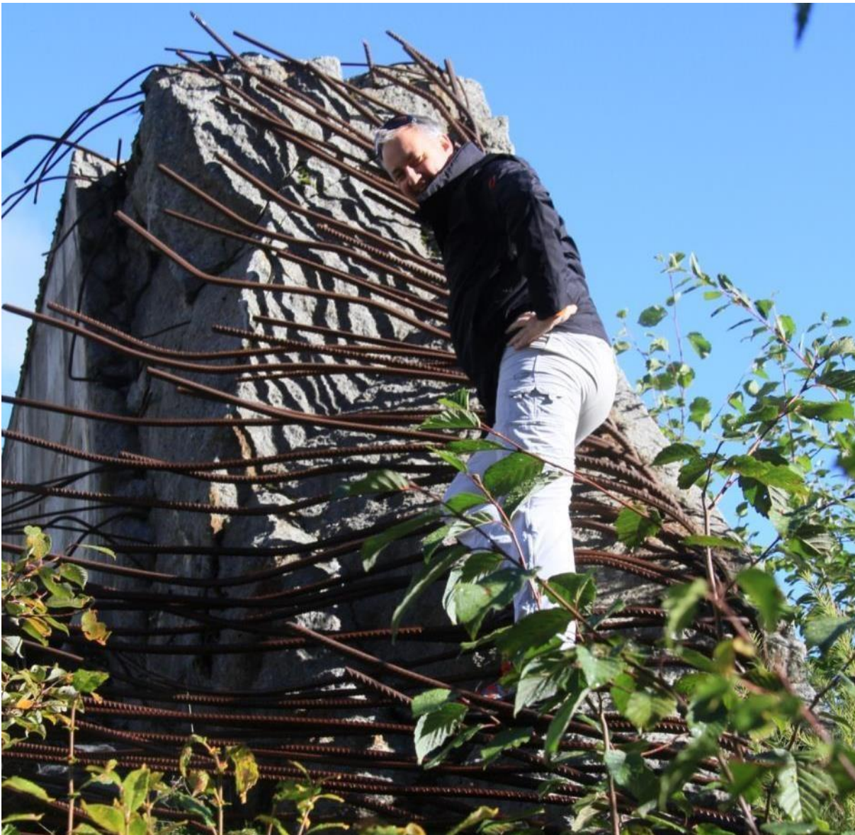
Abbildung 11: Tacconnaz, 1999 zerstörte Lawinenbremswerke mit Technischem Referent (© Ribitsch)
