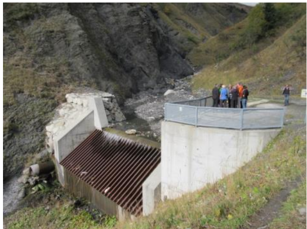
Abbildung 14 Ausleitungsbauwerk, Tiroler Wehr, am Grabeneingang.
