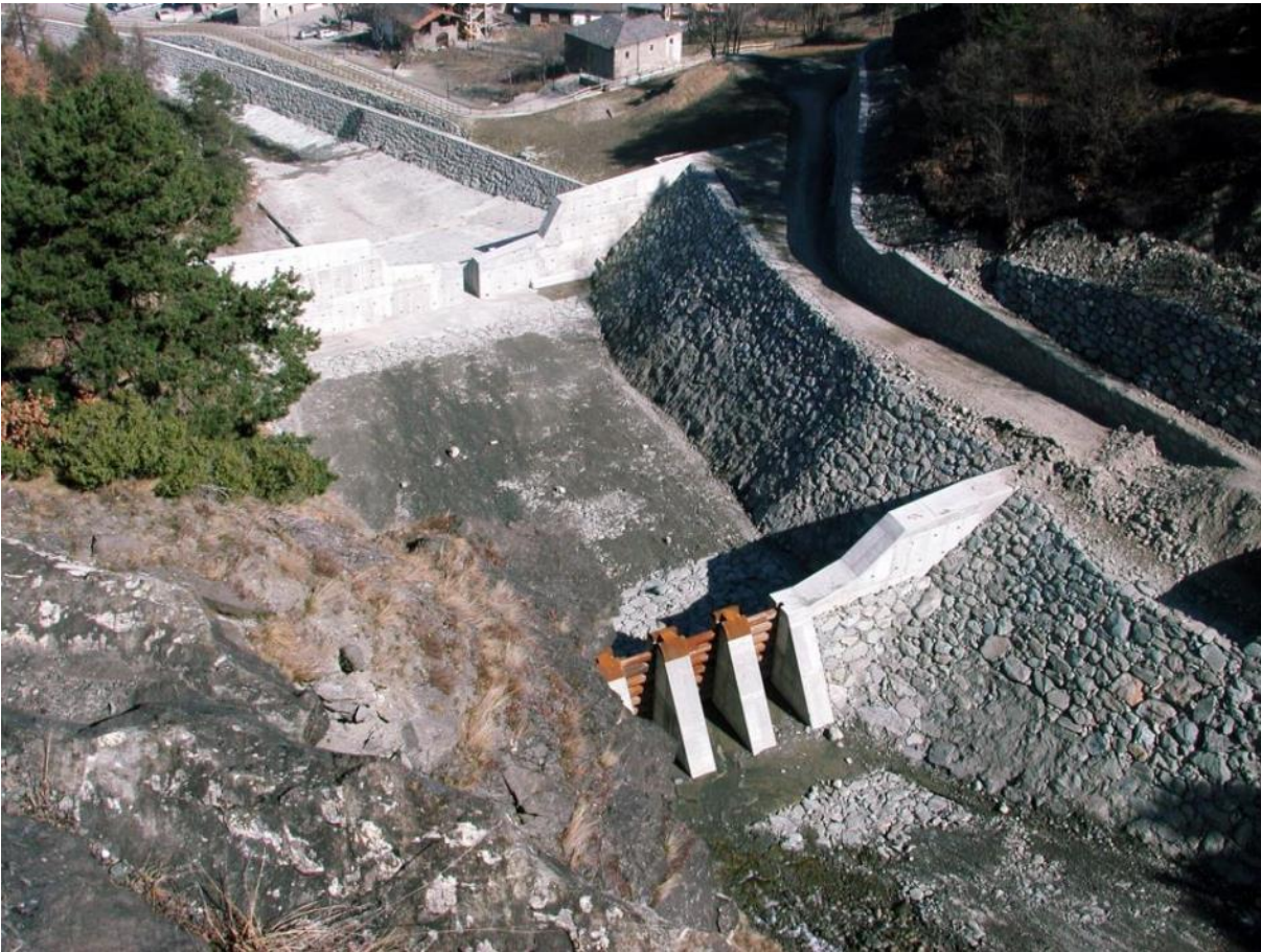
Abbildung 6: „Baustelle am Torrente Comboè“: Sortierwerk, Schlitzsperre und Unterlaufkünette in der Bauphase, Quelle: Valerio Segor
